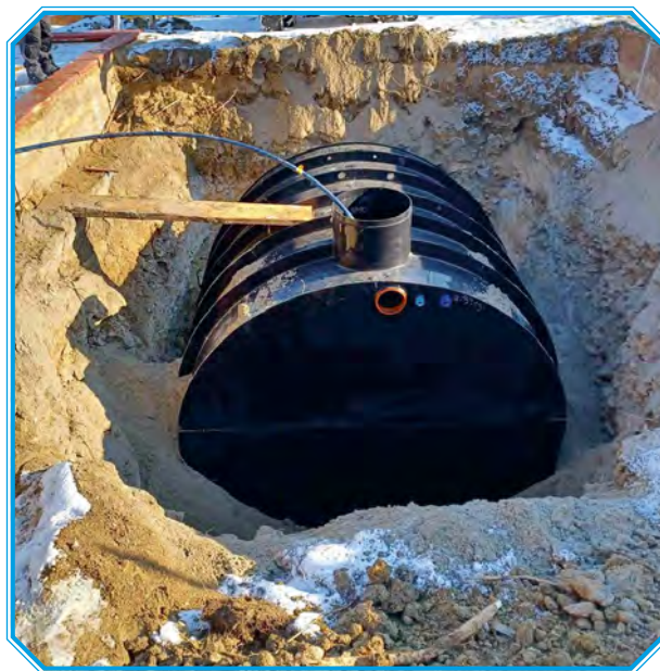
Obr. č.36: Podzemná retenčná nádrž na zber zrážkovej vody v areáli škôlky (zdroj: archív MČ Bratislava-Karlova Ves)
