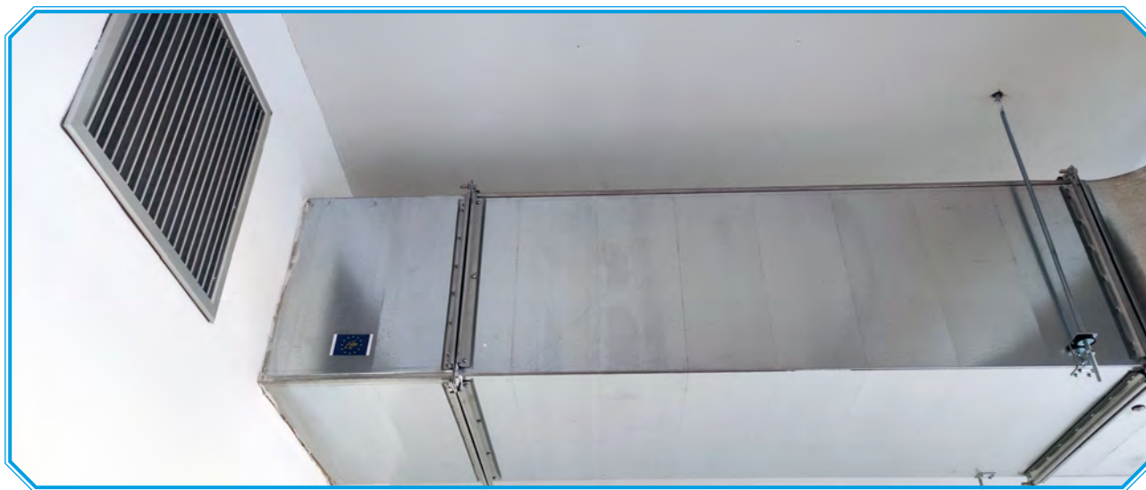
Obr. č.32 a č.33: Riadené vetranie pomocou rekuperácie vzduchu v triedach, spálňach a v kuchyni (zdroj: archív MČ Bratislava-Karlova Ves)
