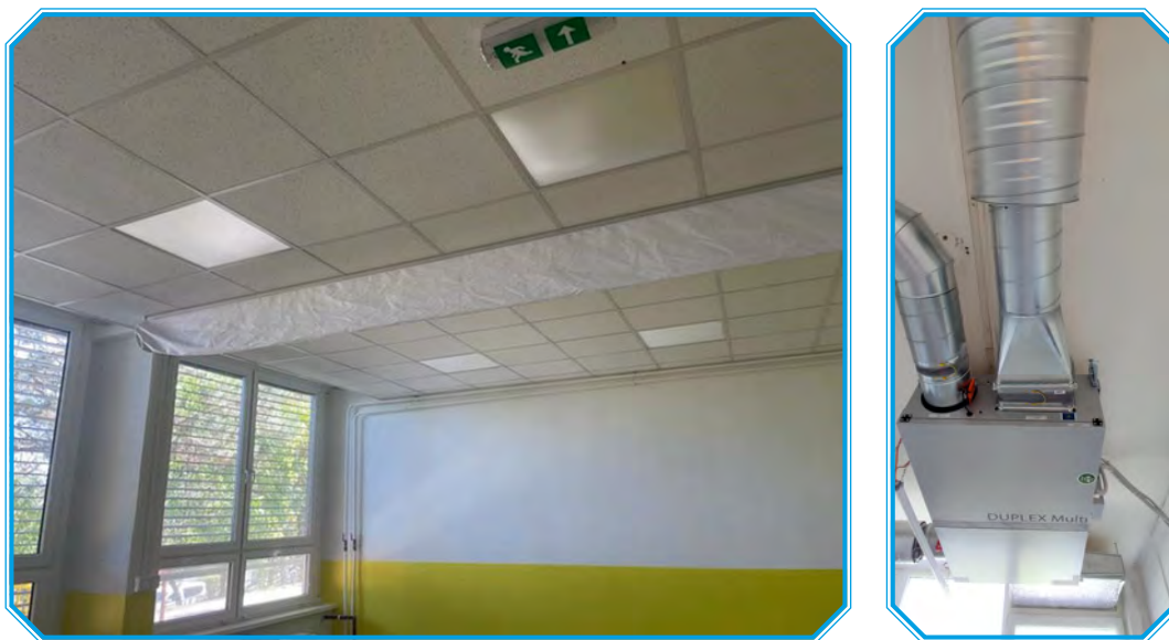
Obr. č. 13: Riadené vetranie – látkové rukávy pod stropom s prívodom čistého vzduchu. Potrubie nasávaajúce čerstvý vzduch z átriá a odvádzajúce odpadový vzduch. (zdroj: archív MČ BRATISLAVA-KARLOVA VES)
